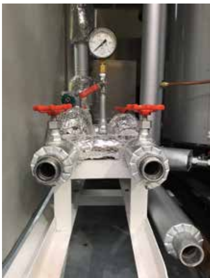
排気・給水口
