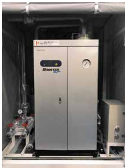
サムソンボイラー
