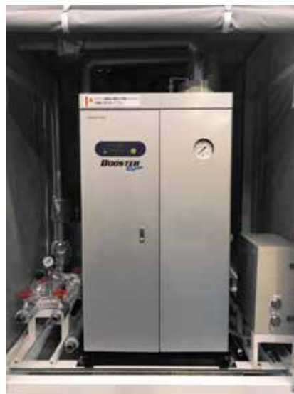
サムソンボイラー
