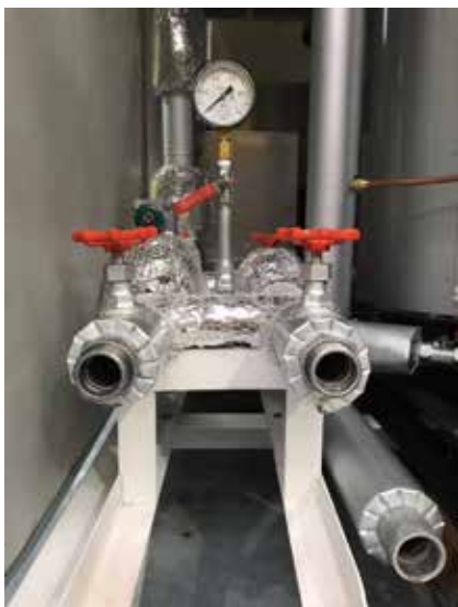
排気・給水口
